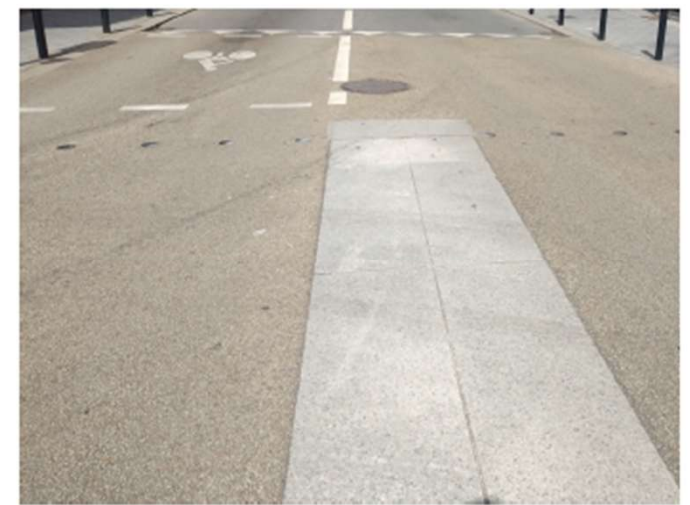
Enrobé clair, hydrofugé, Gare nord, Nantes
